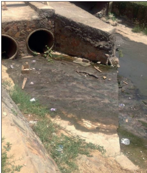
Figura 3 – Entrada de efluente no Rio Alambique, centro de Senhor do Bonfim
