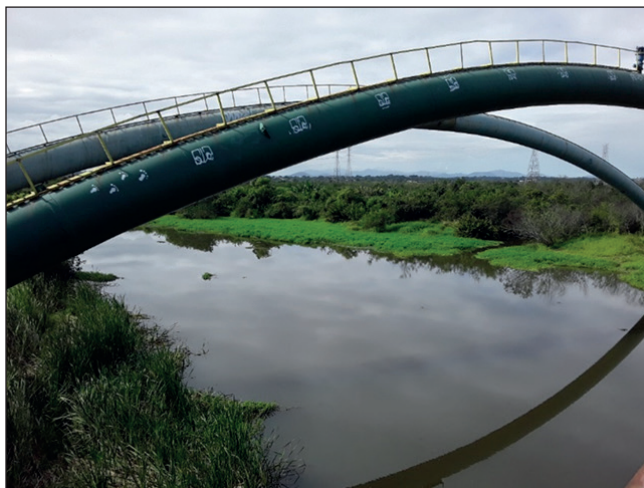
Figura 7 – Demandas hídricas para abastecimento doméstico do Leste Metropolitano. Adutora Paraíso do Sistema Imununa-Laranjal da CEDAE cruzando o Rio Caceribu. Transporte de água bruta da bacia Guapi-Macacu para a ETA-Laranjal
